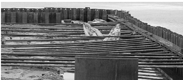
Рисунок 6. Повреждение после паводка стальных тяг, фиксирующих положение стального шпунта «Ларсена» (справа – глыбы льда и деформированные тяги)
